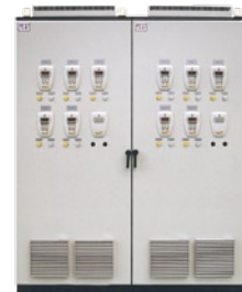
Paneles de baja tensión
